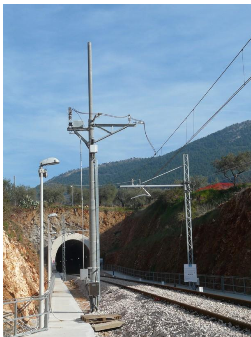
Impianto messa a terra della linea di contatto
