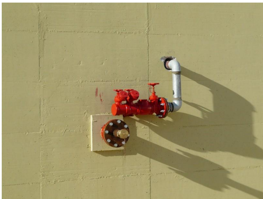
Particolare attacco pompa per VV.F.
