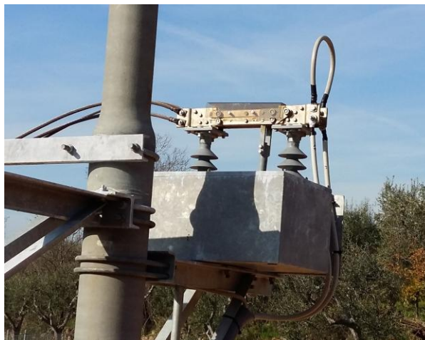
Sezionatore con lama di terra chiusa
