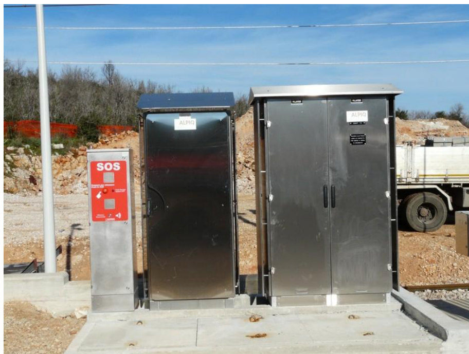
Colonna SOS e quadro elettrico di disalimentazione linea elettrica
