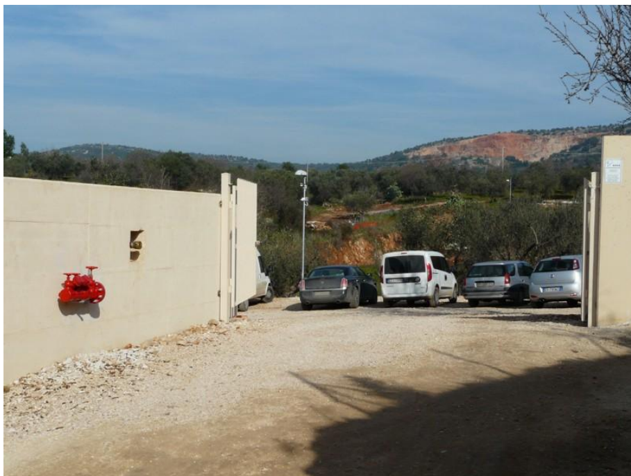
Accesso area tecnica
