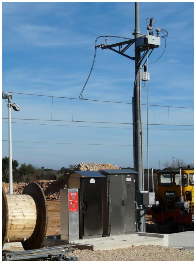
Impianto di messa a terra della linea di contatto
